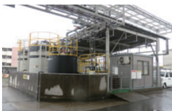
工程系排水処理設備全体
