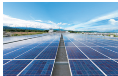
郡山第二事業所の太陽発電設備
