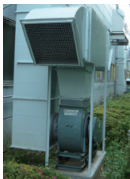
排気口の消音対策
