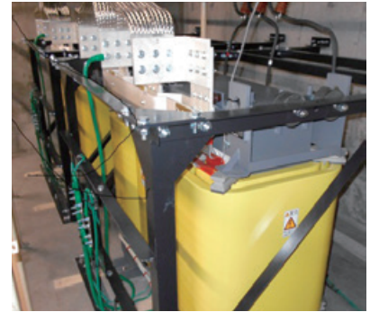
低損失変圧器
