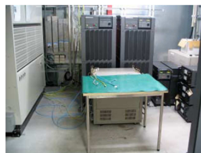
対向機設置室 (電源盤室)
