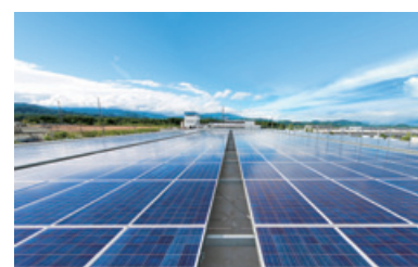
郡山第二事業所の太陽発電設備
