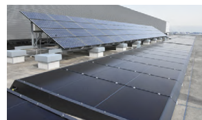
太陽光発電設備(厚木地区)
