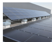
太陽光発電設備 (厚木地区)
