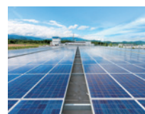
太陽光発電設備 (東北地区)
