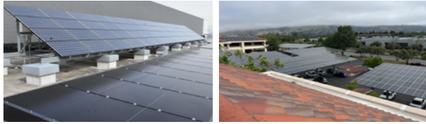
厚木地区の太陽光発電設備
