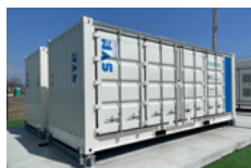
東北地区の蓄電設備
