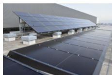
厚木地区の太陽光発電設備
