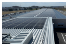
東北地区の太陽光発電設備
