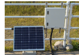
遠隔監視装置盤とソーラーパネル
