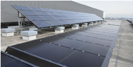
太陽光自家発電設備
