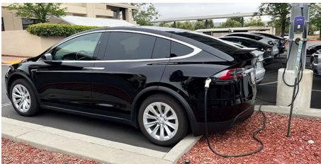
パーキングエリアの充電設備
