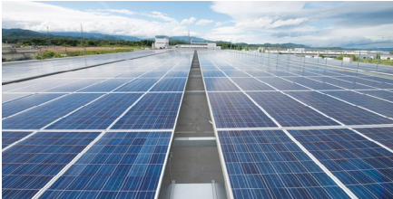
太陽光自家発電設備
