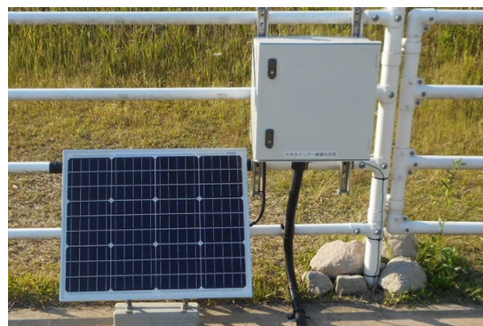
遠隔監視装置とソーラーパネル
