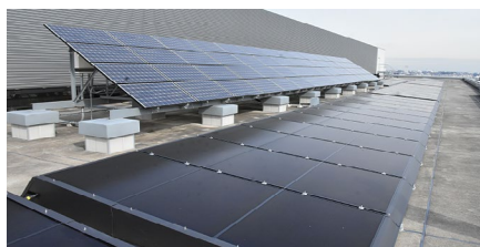
太陽光パネル
