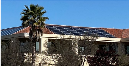
太陽光発電設備
