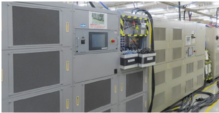
回生電源検査設備
