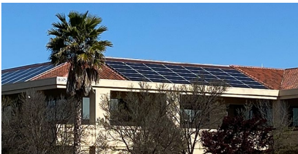
太陽光発電設備
