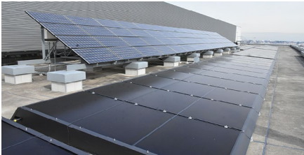
太陽光自家発電設備
