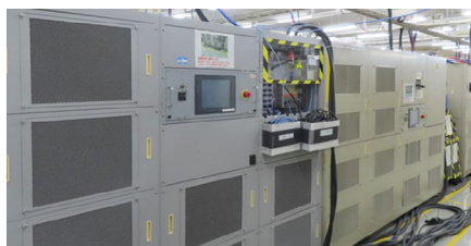
回生電源検査設備
