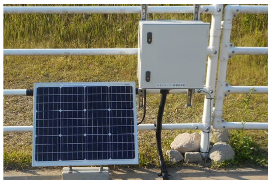
遠隔監視装置盤とソーラーパネル
