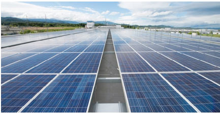
太陽光自家発電設備
