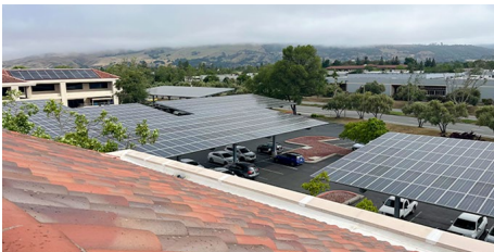
カーポートの太陽光パネル
