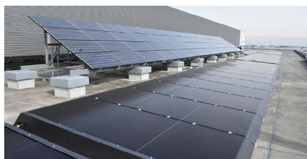
太陽光パネル
