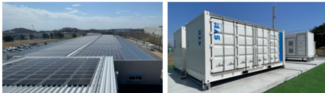
東北地区の太陽光発電設備(左)と蓄電設備(右)
