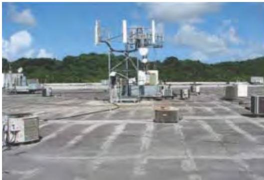
天线的腐蚀锈油可能导致无源互调现象
